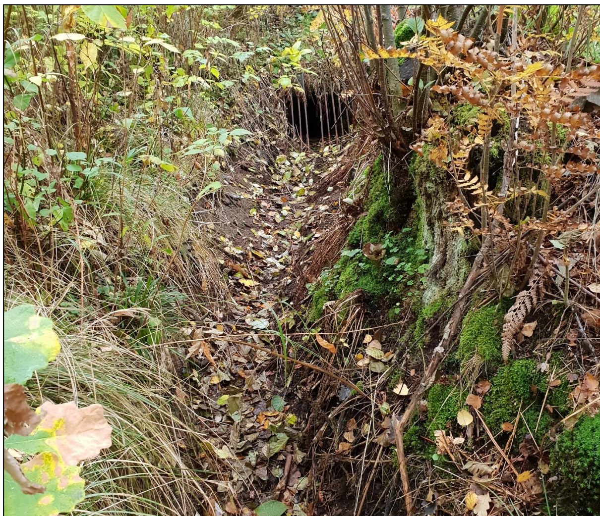
Figur 7. Dike och dagvattenledning, 300 mm BTG med galler, som avleder dagvatten från lågpunktsområdet.
